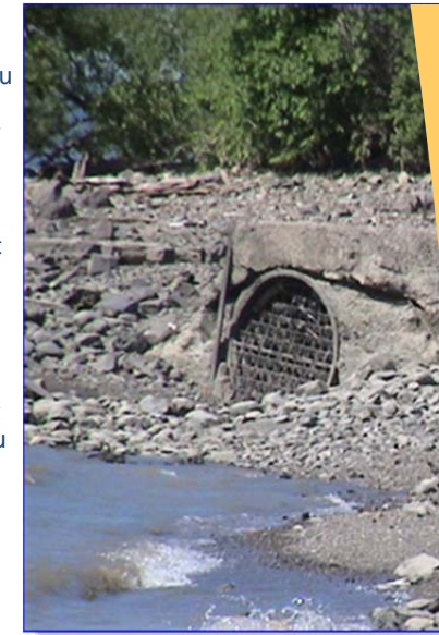
Trop-plein déversant les eaux usées sans traitement en temps de pluie
